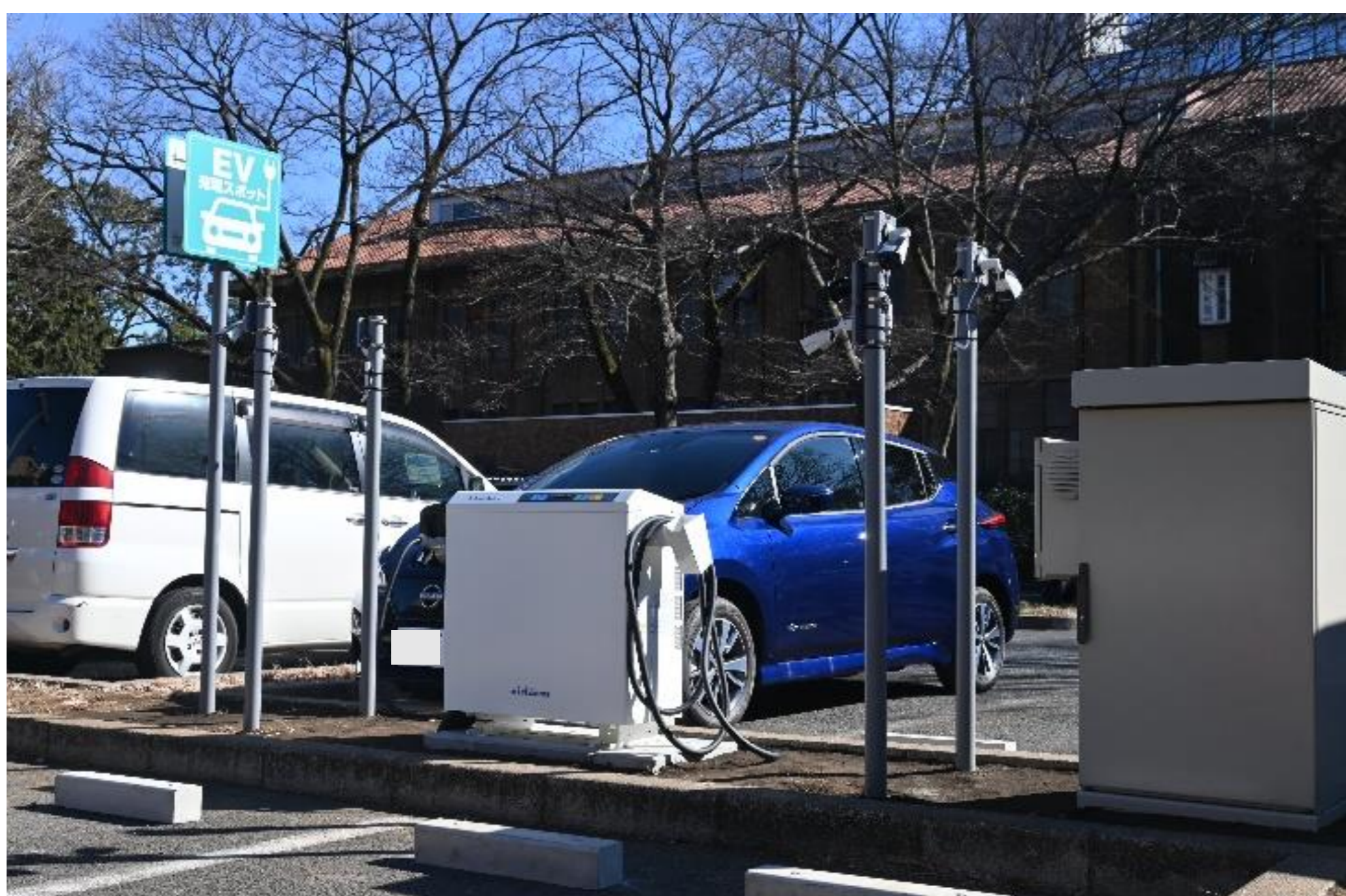
電気自動車充電テストベッド
