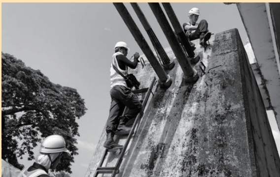
写真2 主ケーブルの定着部付近のカバーを取って内部の腐食状況を調査（Panmawadi 橋）
