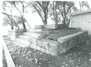
▲平成3年8月。下部は埋もれている。
