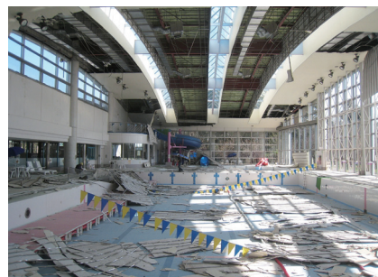
東日本大震災での天井落下事例
