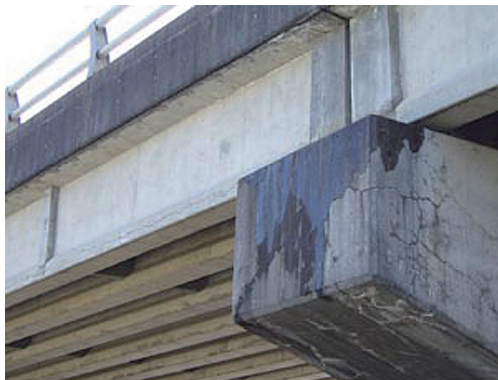
アルカリ骨材反応による劣化事例
