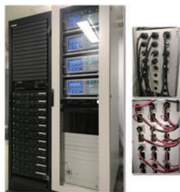
データ基盤電力測定・制御実験システム A power measurement and control experiment system for data platform
