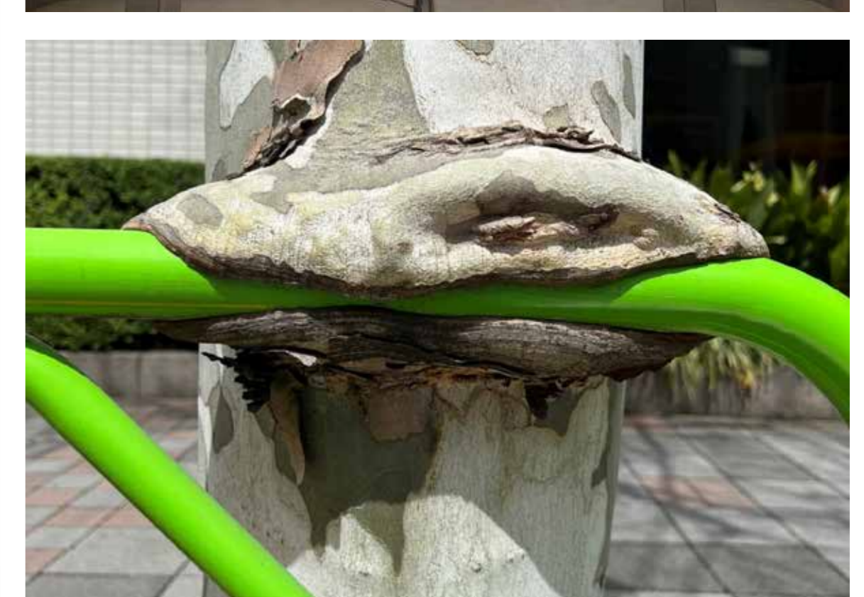
植物の呑み込み現象の調査
