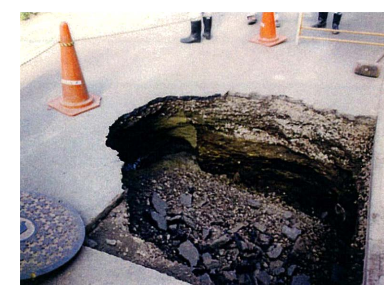
下水管の腐食による道路陥没
