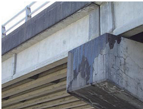
アルカリ骨材反応による劣化事例
