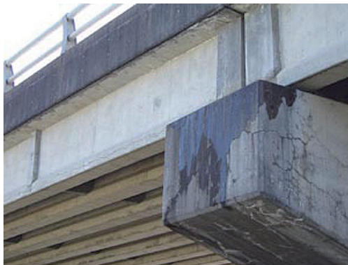
アルカリ骨材反応による劣化事例
