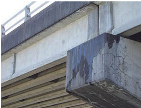
アルカリ骨材反応による劣化事例
