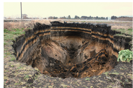
都城畑地の大規模地盤陥没 https://geo.iis.u-tokyo.ac.jp
