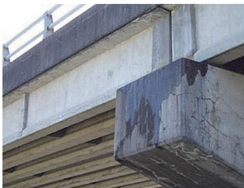
アルカリ骨材反応による劣化事例
