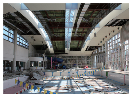
東日本大震災での天井落下事例
