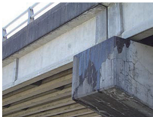
アルカリ骨材反応による劣化事例
