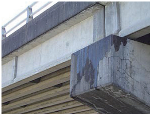
アルカリ骨材反応による劣化事例
