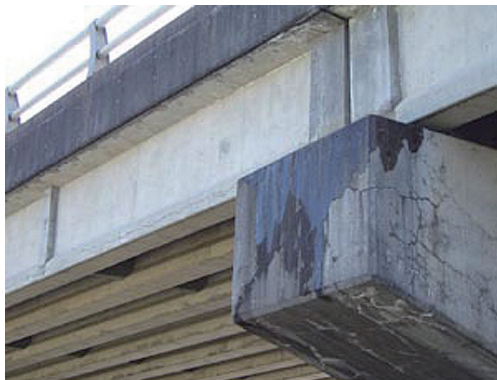
アルカリ骨材反応による劣化事例
