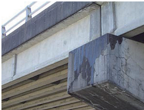
アルカリ骨材反応による劣化事例
