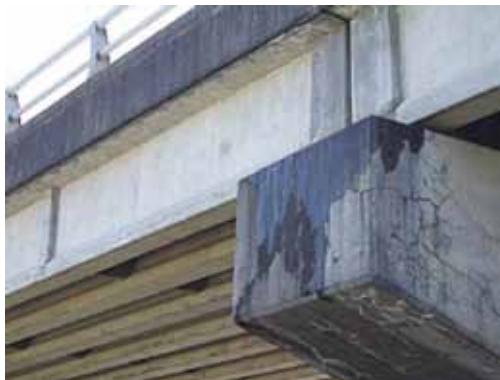
アルカリ骨材反応による劣化事例
