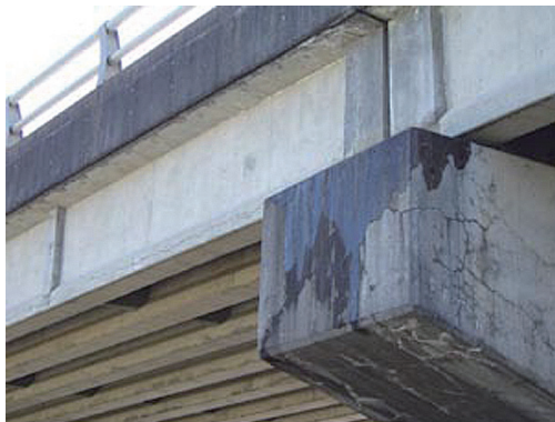
アルカリ骨材反応による劣化事例
