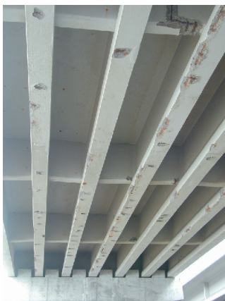
劣化したコンクリート橋
