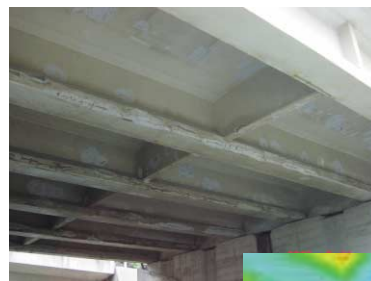
劣化したコンクリート道路橋
