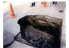
下水管の腐食による道路陥没
