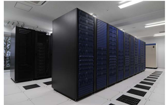
過去30年にわたる観測データを蓄積し地球観測データの統合・解析の基盤となるペタバイトスケールのストレージシステム。
