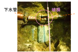
ガス管 錯綜する地中埋設物と下水管の破損
