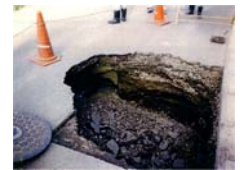
下水管の腐食による道路陥没
