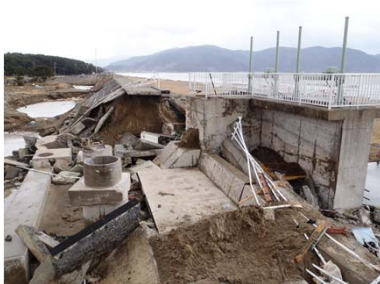
津波で決壊した海岸堤防(石巻市)地震後1ヶ月経っても復旧の余裕が無い
