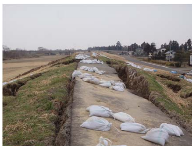
液状化により損傷した堤防(江合川左岸)被災箇所と周辺地形に密接な関係がある
