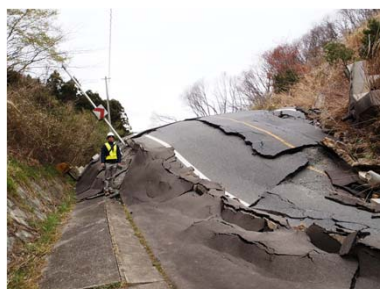
大崩壊斜面下部の道路変状(いわき市)降雨時の余震による。斜面は風化堆積岩
