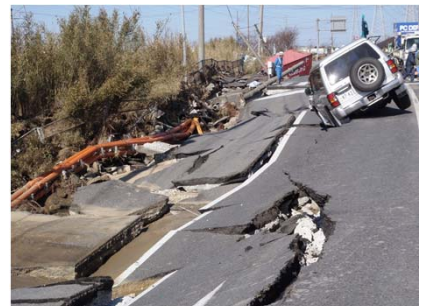
液状化と津波により二重被災した道路(神栖市)高電圧ケーブル(6万4千ボルト)が剥き出しに
