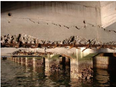
コンクリート構造物の劣化(塩害)
