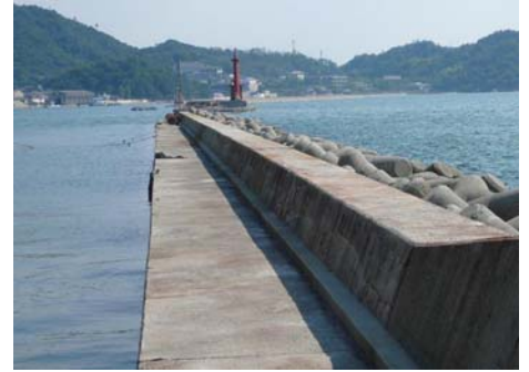
コンクリート構造物の劣化(ASR)
