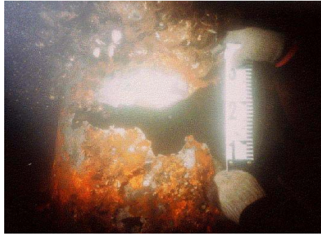
鋼構造物の腐食
