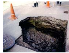
下水管の腐食による道路陥没
