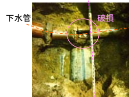
錯綜する地中埋設物と下水管の破損
