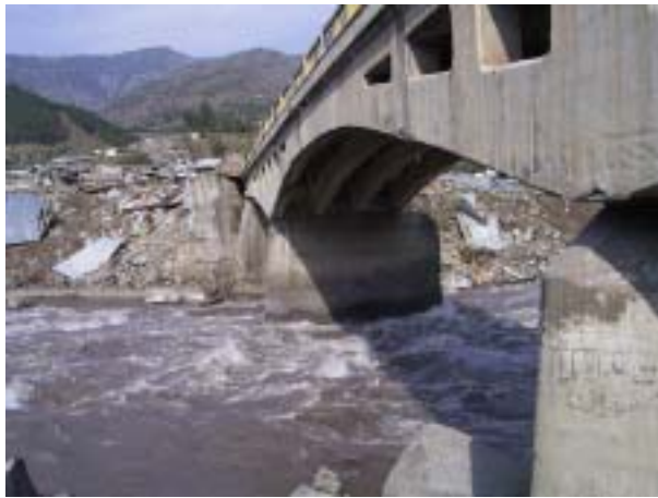
国道15号線バラコート(Balakot)橋:バラコートの中心を流れる Kunhar 川に架かる3径間連続 RC アーチ橋である。桁全体が南側(下流側)に 105cm ほどずれている。救援物資を積んだトラックが行き交い、通行制限はかけられていない。
