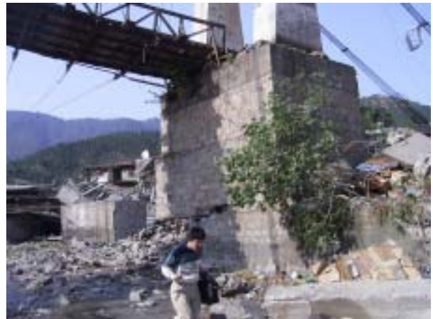
バラコート橋の南 100mにある吊橋の主塔基礎:この基礎も1m程度南にずれている。バラコート市内を通る国道15号の街灯も南北方向に強くゆすられた痕跡を残していて、この街が南北に強い揺れを受けたことが推定される。
