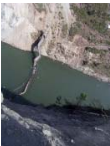
ムザファラバード北の吊橋の崩壊:このような中小の吊橋の多くは歩行者、ロバなどのためのものであるが、山村の生活を支える重要な施設である。
