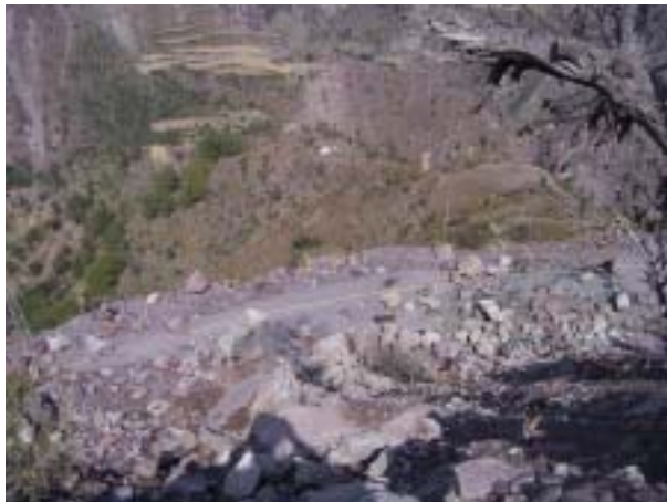
バラコート北 15km の国道 15 号線:褶曲の激しい千枚岩(粘板岩)の崩落が随所に見られ、これらが山岳地帯の唯一の動脈を寸断している。他に迂回路がなく、標高の低い箇所から順次道路のクリアリングが行われているが、積雪期を目前にその作業は捗らない。工事現場が同時に救援物資の車で届く最後の場所になっていて、こより先はロバや人力による物資の輸送に頼っている。
