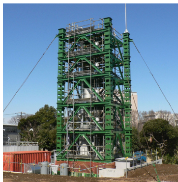
次世代石炭ガス化炉試験装置
