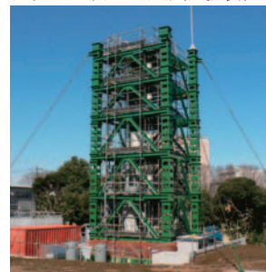
次世代石炭ガス化炉試験装置
