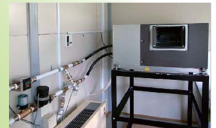
水熱源空調ヒートポンプ
