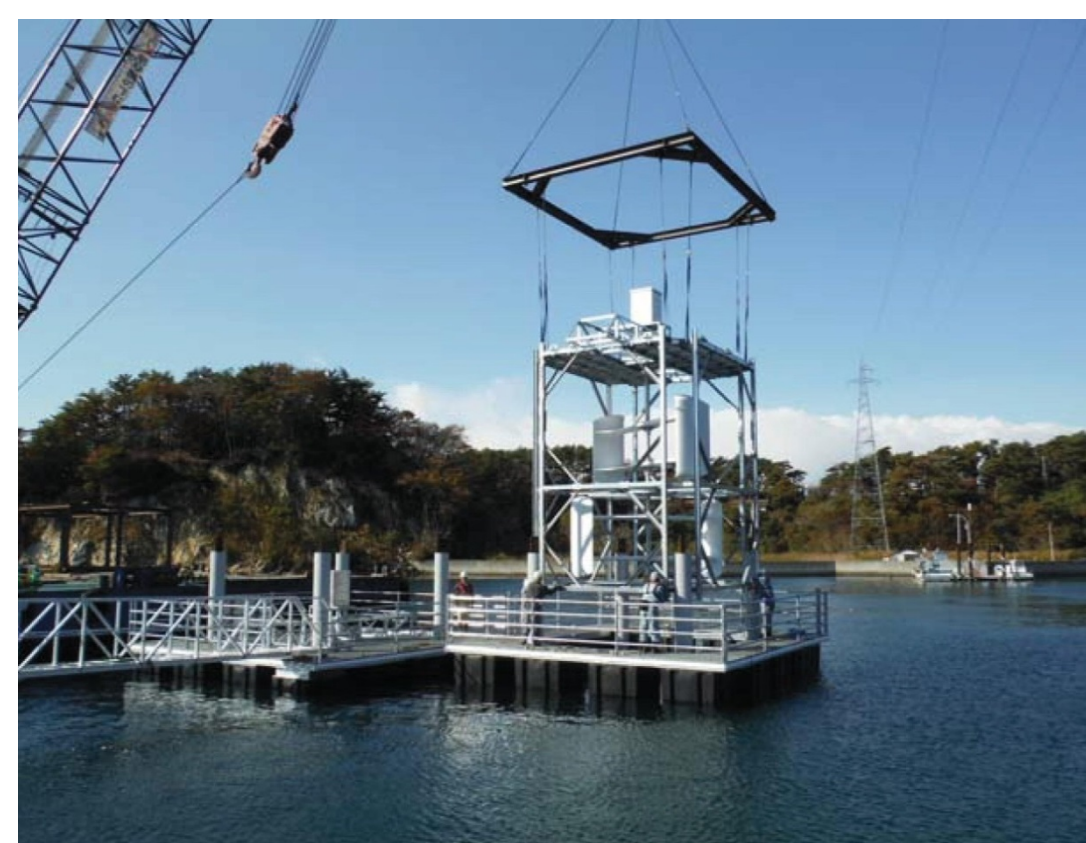
5kW 潮流発電装置の設置状況
